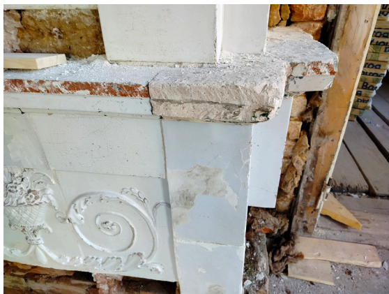
Рис. 18. Стесанный край изразцовой полки калориферной печи и ее угол, восполненный в процессе предыдущих реставраций Fig. 18. The trimmed edge of the tiled shelf of the calorifer stove and its corner, restored during previous repairs
