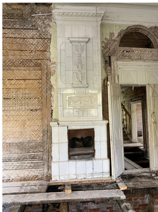
Рис. 8. Отсутствие фундамента изразцового камина на момент начала реставрационных работ в 2020 г.
